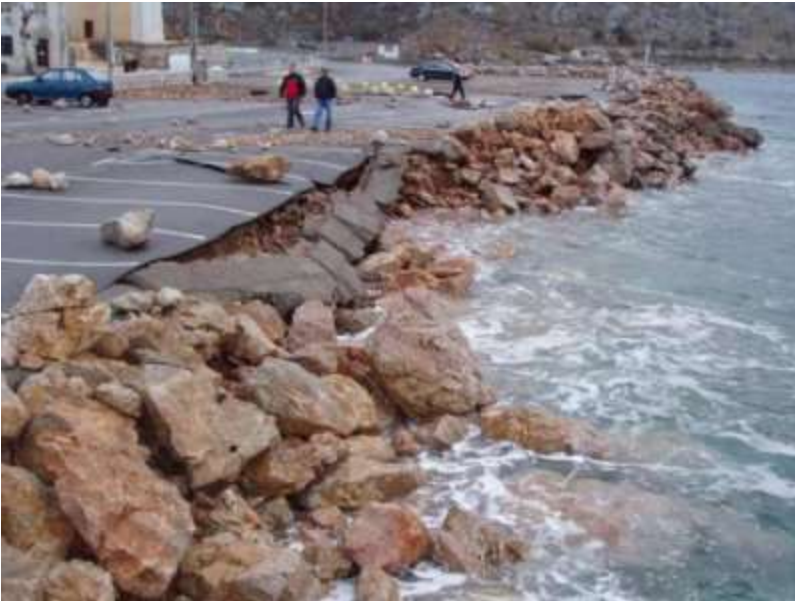
12.12.2008. Karlobag - olujno jugo oštetilo i povuklo u more dio kamenog lukobrana,
